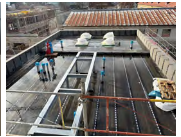
Winterfest abgedichtetes Dach
