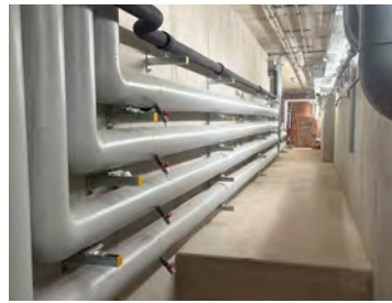
Kollektorgang mit Leitungsrohren
